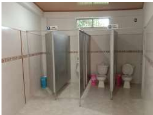
BATERIA DE BAÑOS
