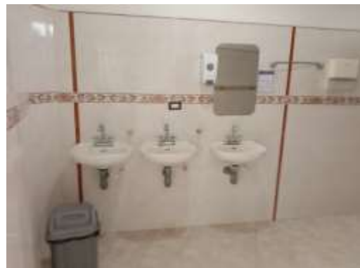
BATERIA DE BAÑOS
